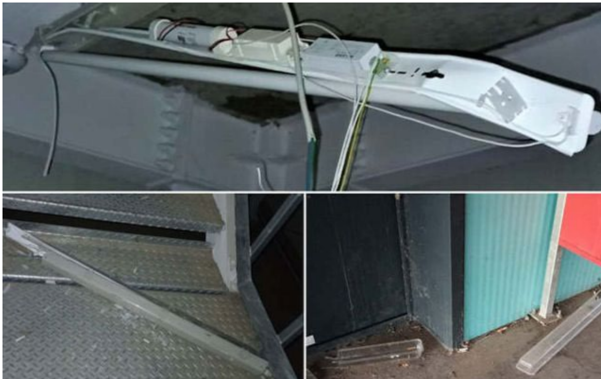
Figura 38 – Vandalizare Fast Park 1 (1)
